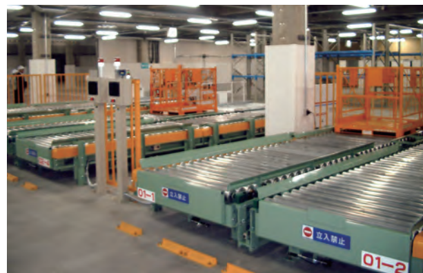
●ステーションコンベヤ
