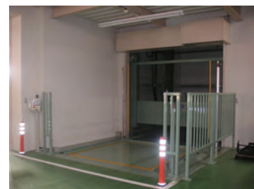
＜侵入防止柵 参考イメージ＞
